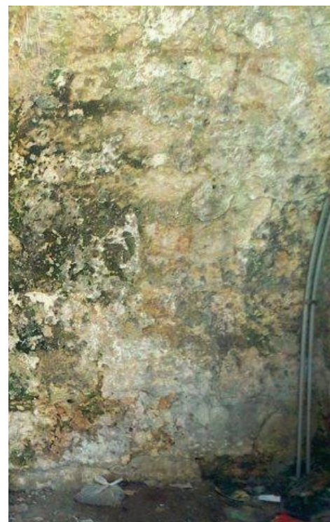
Figura 7. Instalaciones expuestas. Colonias de crecimiento biológico próximas a zona húmeda. Fuente: Autor, 2014
