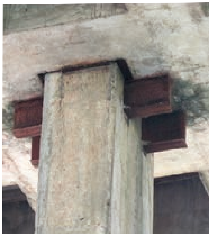
Figura 6. Unión vigas-columna sistema Losa izada. Fricción mediante cuñas de acero. Fuente: Elaboración propia.
