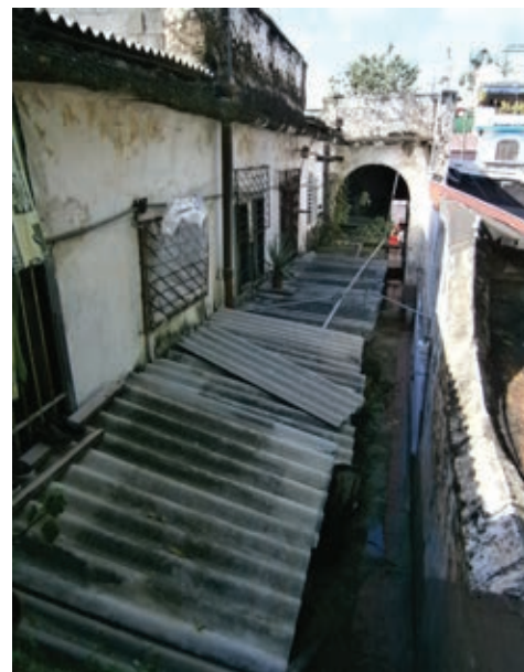
Figura 6: Casa de vecindad intervenida por el estado a partir de construcción de cocinas y baños hacia el patio lateral. Suzarte no. 585, El Canal, La Habana.
