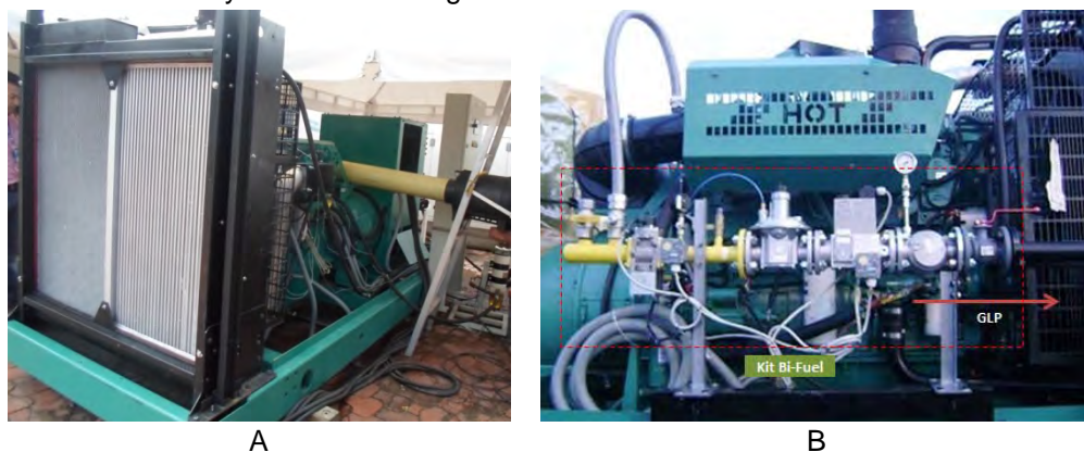
Fig. 2. Motogenerador Cummins DFEH (a) e instalación del Kit Bifuel antes del ingreso de aire al turbocargador (b)
